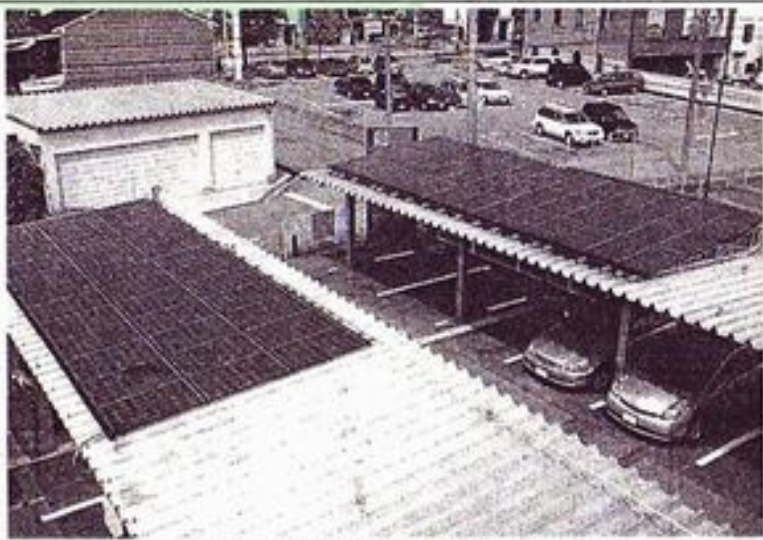
サンコーが自社に設置した太陽光発電システム
